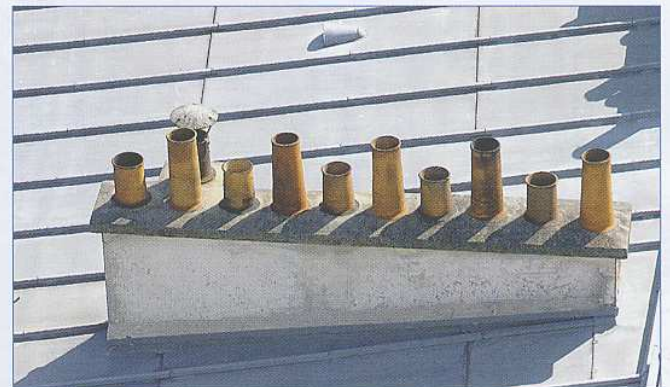
Doc 4 Toit en zinc recouvert d'une pellicule blanchâtre.
