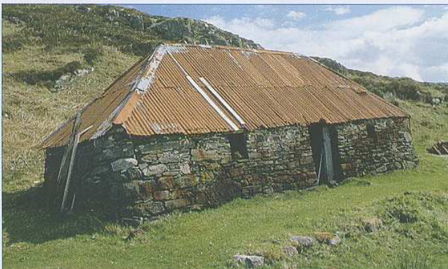
Doc 3 Toiture en tôles de fer rouillées, ce métal se corrompt facilement.
